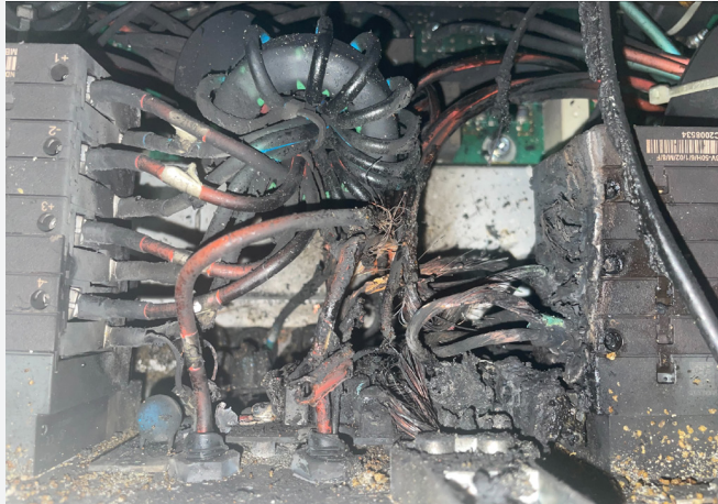
直流侧线缆烧毁
