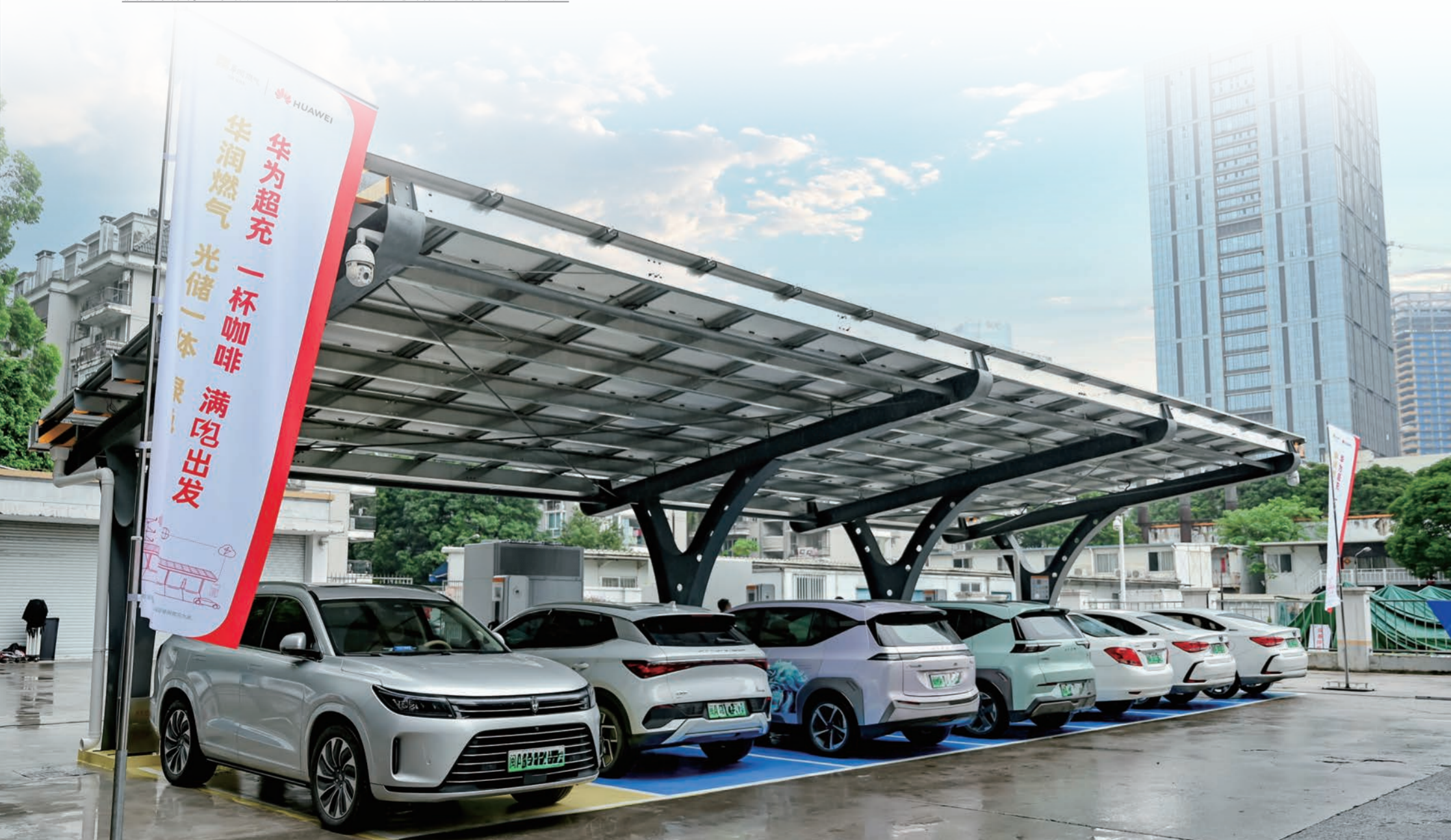
使用设备: 逆变器 / 200KW华为电化学储能系统 / 液冷超充
