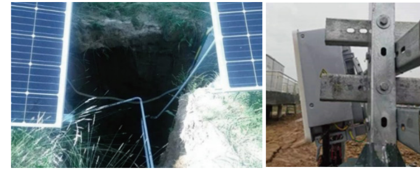
图15 土地沉降导致端子接触不良
