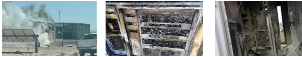
图18 逆变器、汇流箱因直流短路起火照片
