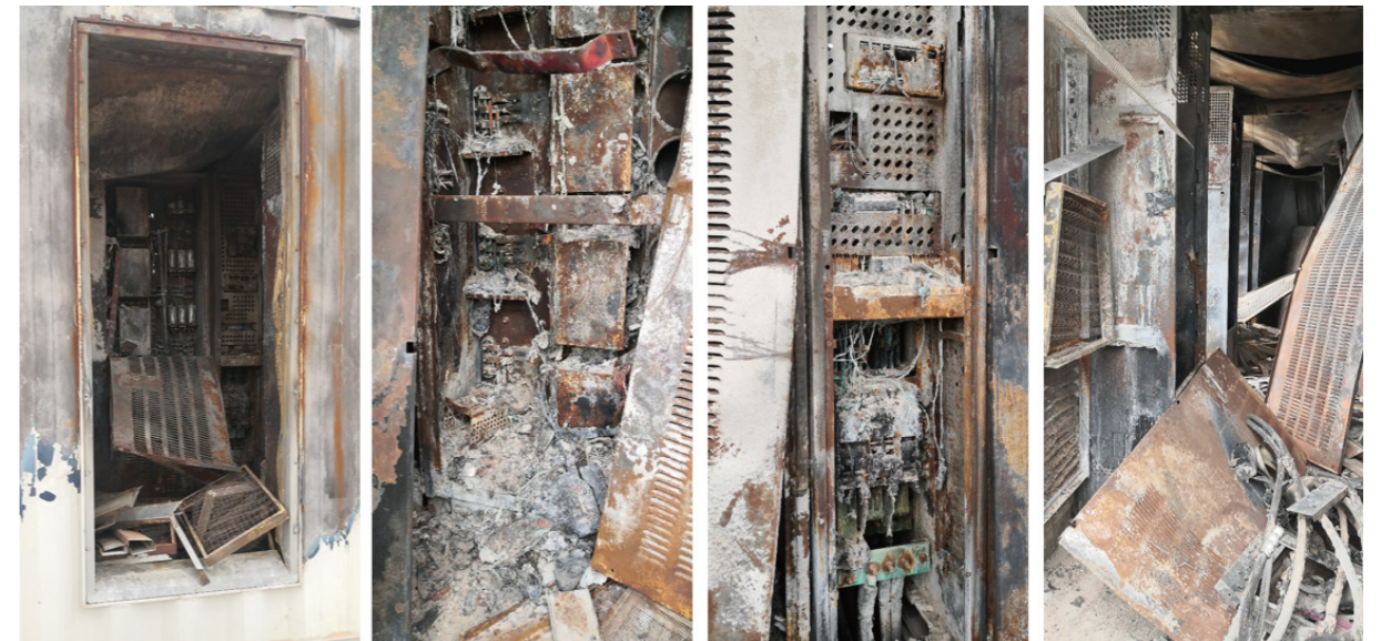
图11 逆变器绝缘故障导致起火事故
