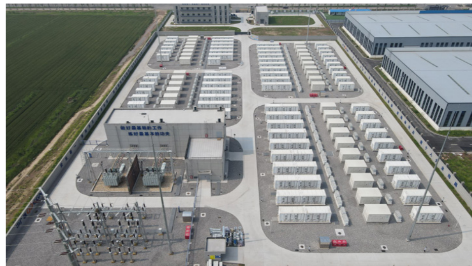
> 湖北公安县 储能电站
