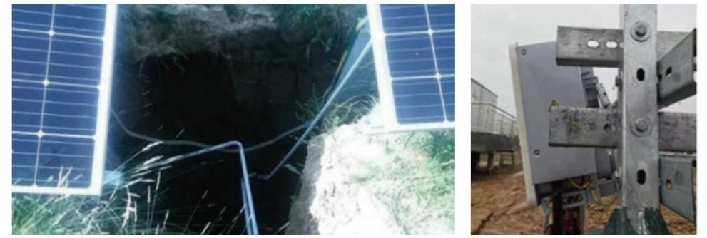
土地沉降导致端子接触不良
