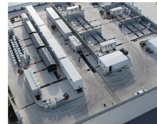
构网型储能平台应用与测试中心
