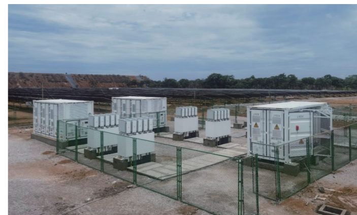
图 3-1：M 矿 18MW 光伏 +10MWh 储能铜矿微电网项目
