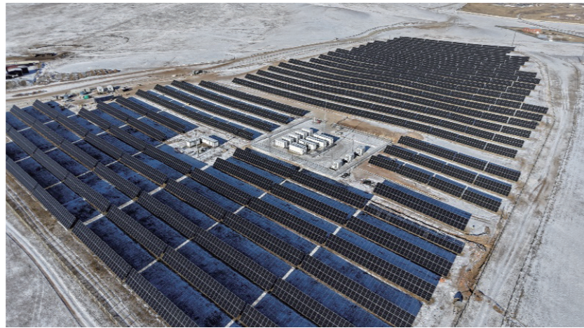
图 3-2：蒙古 MAK 53.7MW 光伏 +139.5MWh 储能煤矿微电网项目 * 二期 17.2MW 光伏 +36.5MWh 储能 2026 年完成交付
