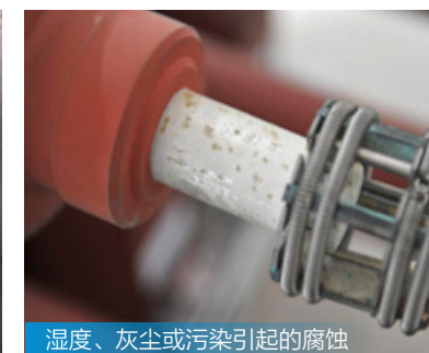
湿度、灰尘或污染引起的腐蚀
