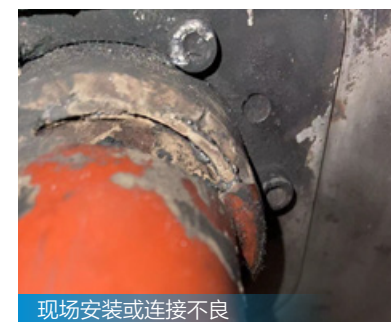
现场安装或连接不良
