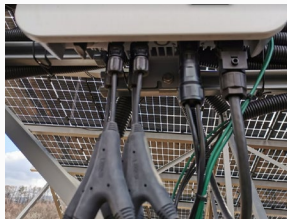
DC/ACケーブルはストレスを与えないよう配慮します。
