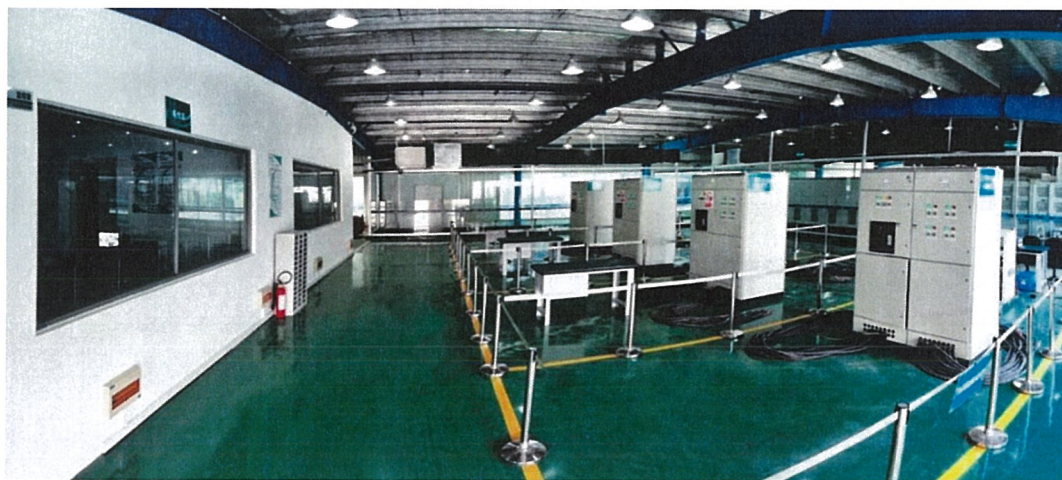
图 2.2 检测部（江宁）光伏逆变器并网检测平台
