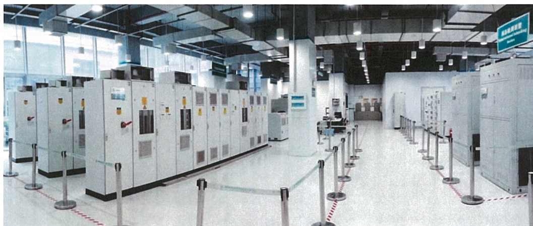
图 2.1 检测部（浦口）光伏逆变器并网检测平台
